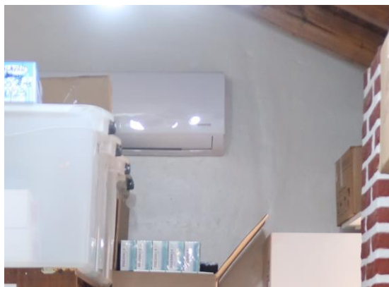
Klimaanlage im Flur und in der Apotheke
